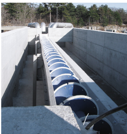
OVF 300 Drosselbauwerk mit Siebung des Mischwasserablaufs zum Schutz des Vorfluters
