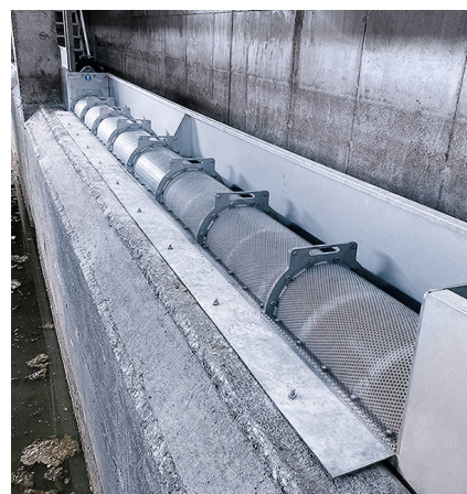
OVF-R 300 Drosselbauwerk mit Siebung
